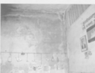
壁が剥がれて痛みが激しい 教室には、机もゴザもない
