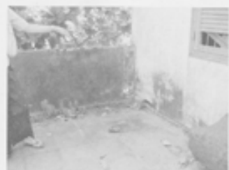
屋上の手すりは落っこちそう 雨漏りをしている
