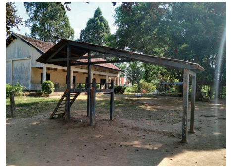
子どもが大好きなすべり台は壊れ、板が外されていた
